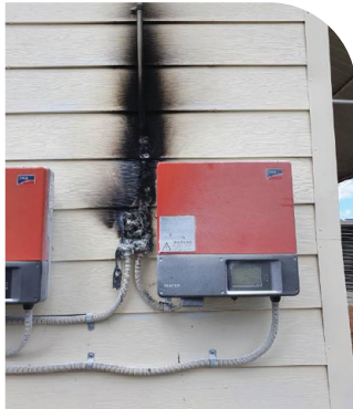
Slika 14: Oštećen inverter usled pregrevanja
